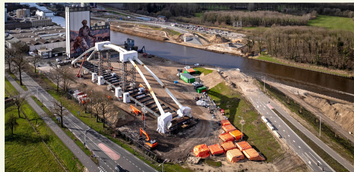
De afgelopen maanden vonden laswerkzaamheden plaats aan de brug op de kade. Op 6 en 7 juni wordt de brug met grote pontons over het Twentekanaal gelegd.
